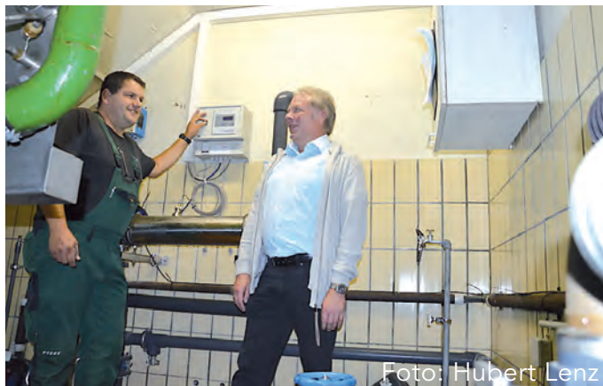
Das Foto zeigt Wassermeister Willi Kegler bei der Prüfung der UV-Anlage mit Bürgermeister Lehnert.
