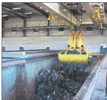
Befüllung der Rotteboxen – heute
